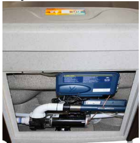
Der Zugang zum Maschinenaggregat befindet sich bei den meisten Whirlpools unter dem oberliegenden Bedienfeld.
