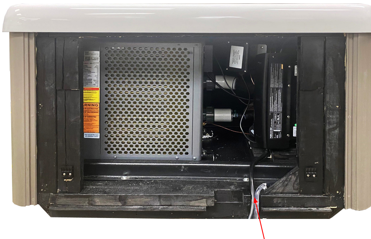
Netzkabel und Abflussrohr im ausgeschnittenen Bereich
